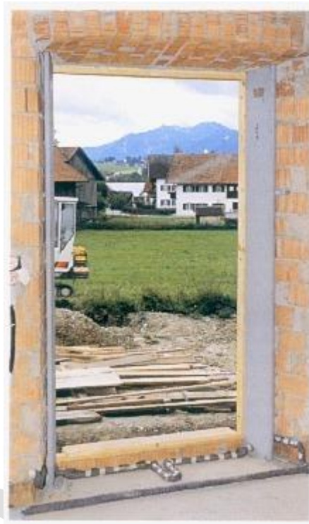
sancal Heizzarge im Rohbau mit angeschlossener Beipassleitung
